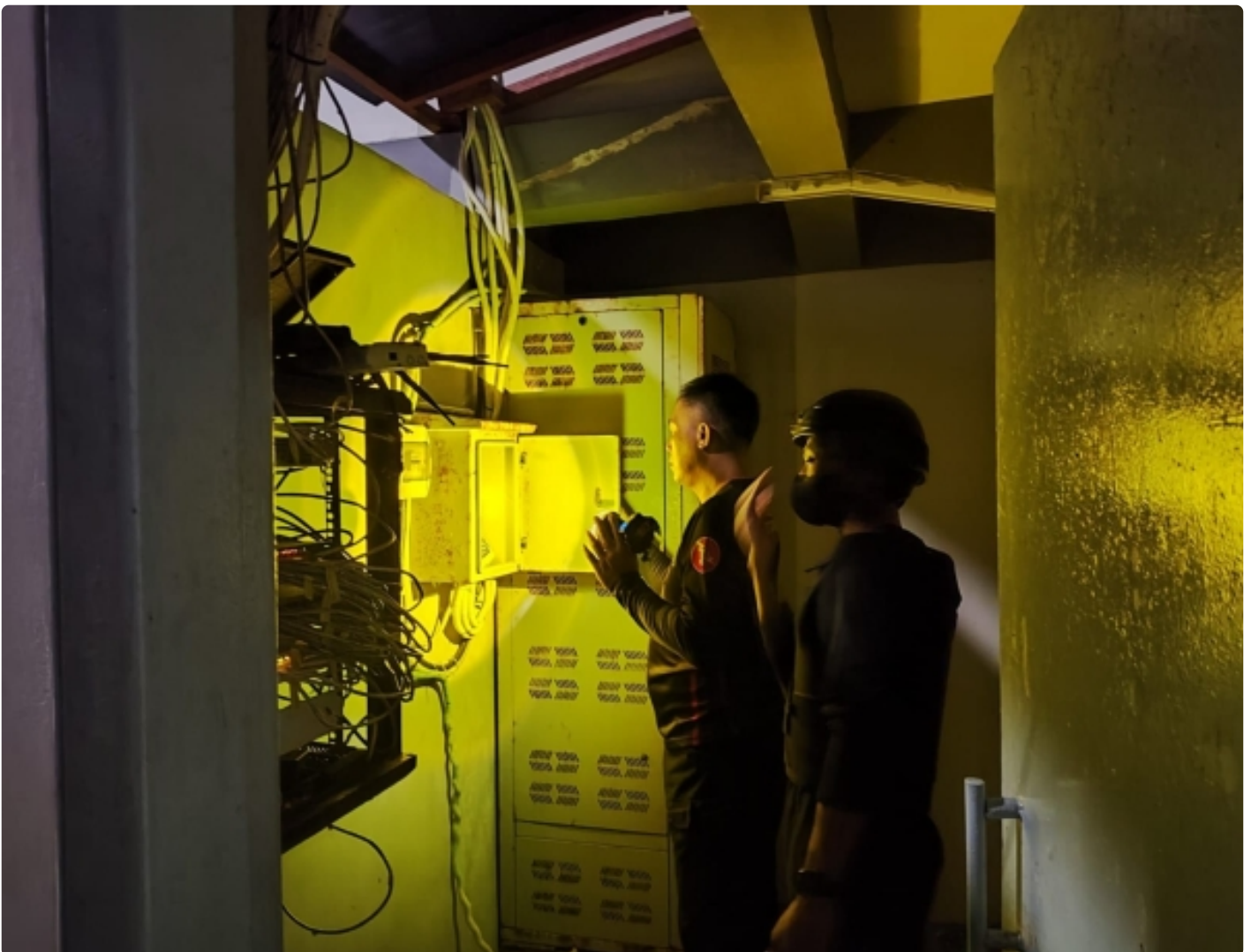
Petugas Lapas Pasir Putih lakukan pengecekan dan perawatan rutin CCTV
